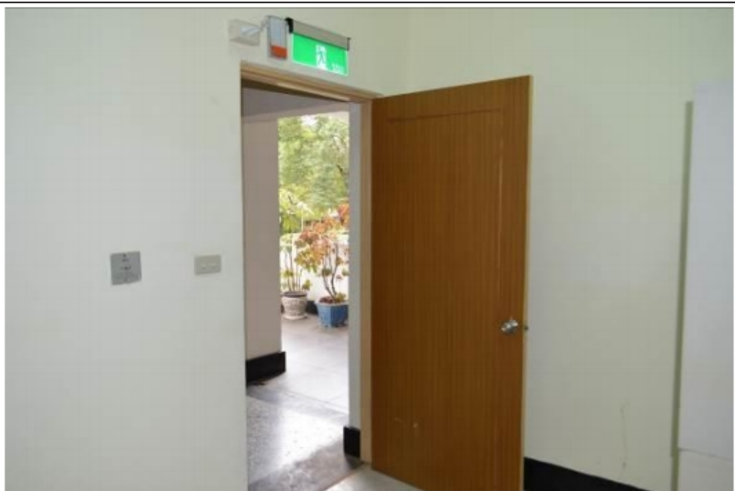
緊急照明設備
