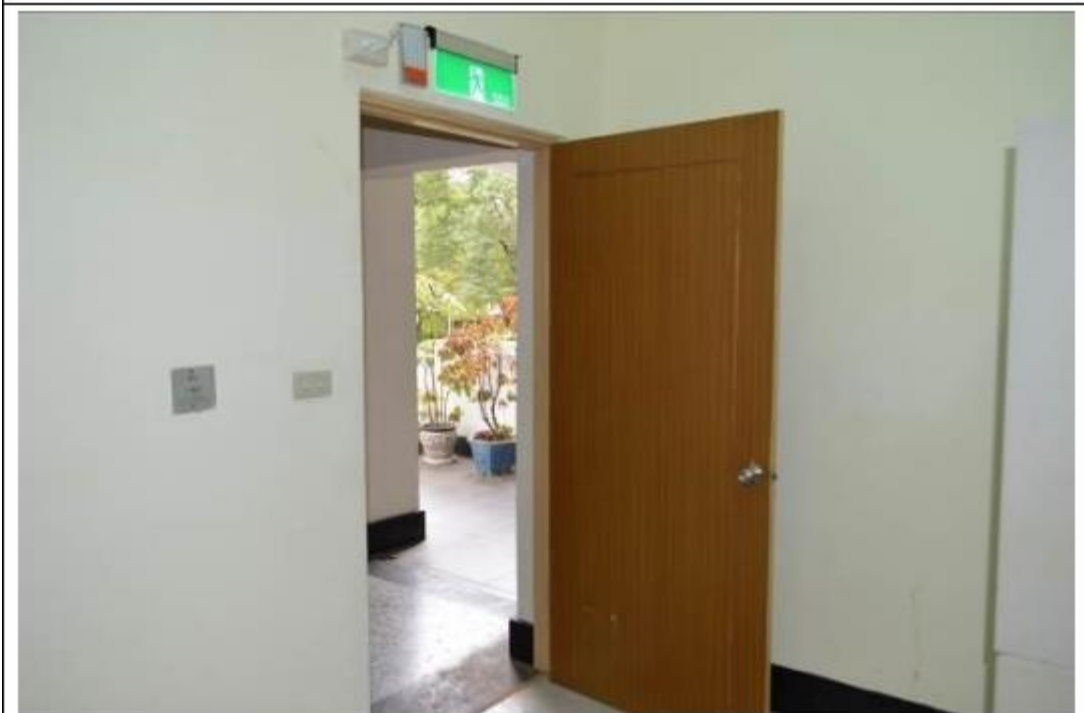
緊急照明設備
